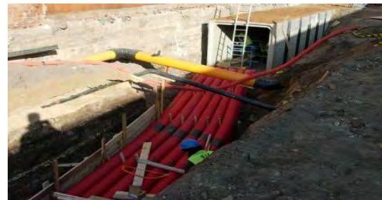
Nouveaux réseaux d'énergie et de télécommunications
